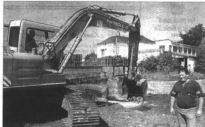
Un ancien barrage hydroélectrique commence à être démantelé à l'usine Ralstan-Purina à Saint-Philbert-sur-Risle. Garde rivière au S.I.B.V.R. (syndicat intercommunal de la basse vallée de la Risle), Bruno Durand veille au bon déroulement des opérations.
